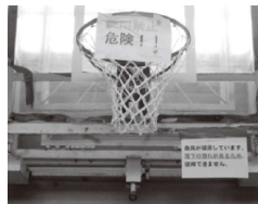
▲破損したバスケットゴール（福岡中）
