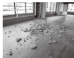
▲中央公民館 体育室断熱材落下
