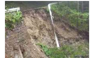
▲付知町の林道崩壊
