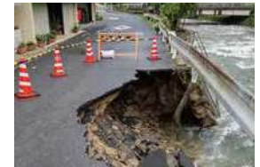
▲蛭川の和田川沿いの市道路肩崩壊
