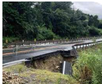
▲国道19号 落合清水路路肩崩落現場
