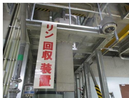
汚泥処理センター(内部)
