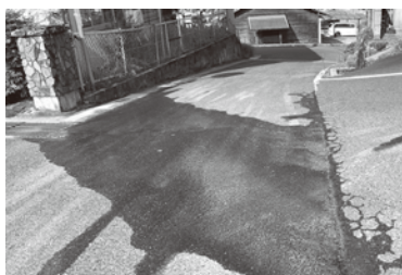
漏水のイメージ
