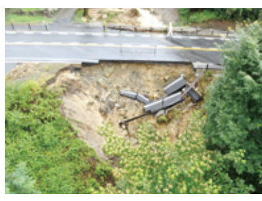
▲国道19号線路面崩落現場 (多治見砂防国道事務所撮影)
