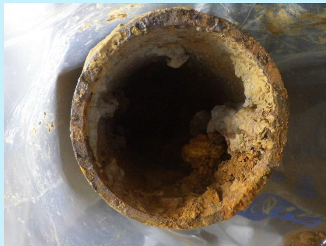
▼老朽化した管路
