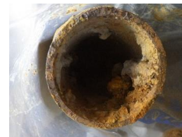
■ 老朽化した管
