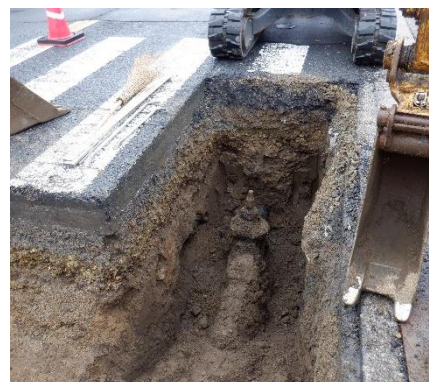
老朽化した水道管
