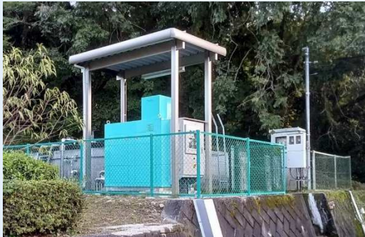
●原浄水場（山口）シフォンタンク
