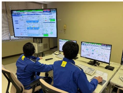
■中津川浄化管理センター 中央監視制御装置 (R7年度更新)
