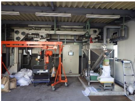
■坂本北部クリーンセンターコンポスト製造機
