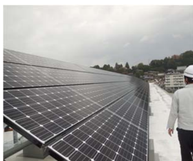
太陽光発電 (市立東小学校)
