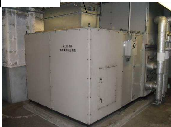
既設空調機(東病棟系統：ACU-10)
