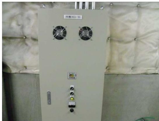
空調機用インバータ盤
