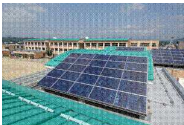
図3-4 中津川市立南小学校の太陽光発電システム（2009年6月9日撮影）
