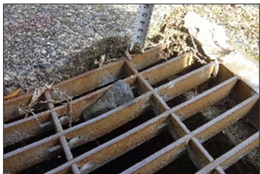
グレーチングの浮き
