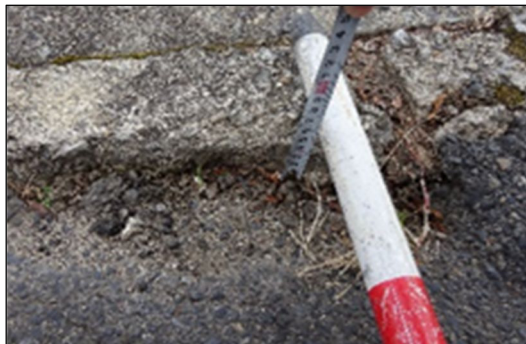
歩道に段差がある
