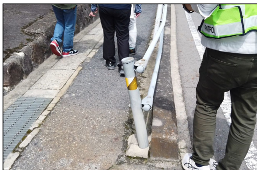
歩道側に変形した横断防止柵
