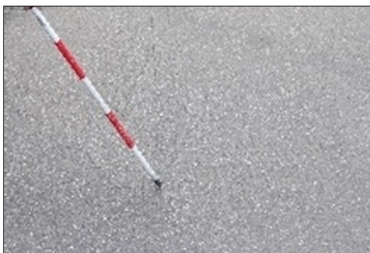
道路標示（白線）が消えている
