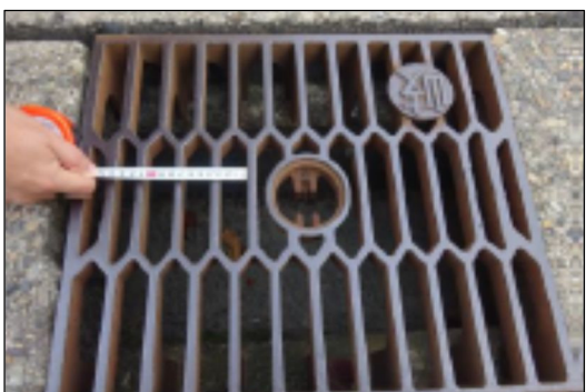
グレーチングのすき間が広い
