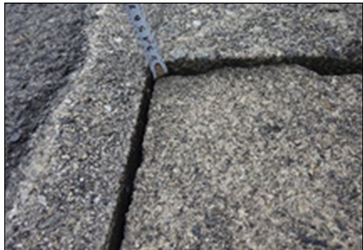
側溝老朽化（両側）、ガタつき、段差
