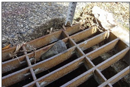
グレーチングの浮き
