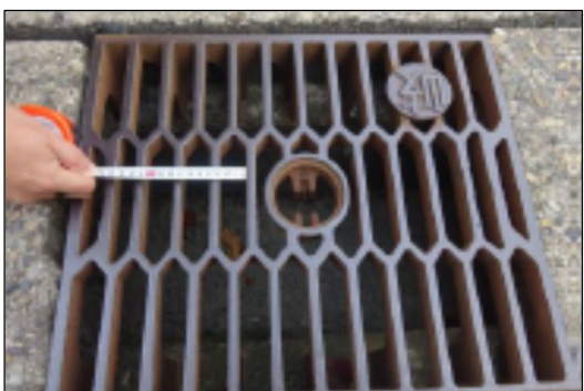
グレーチングのすき間が広い
