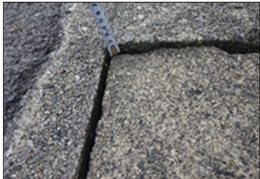
側溝老朽化（両側）、ガタつき、段差
