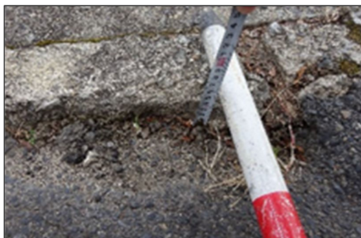
歩道に段差がある
