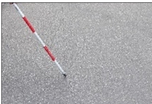
道路標示（白線）が消えている
