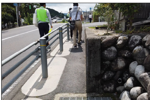
幅の狭い歩道
