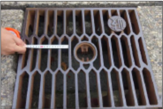
グレーチングのすき間が広い
