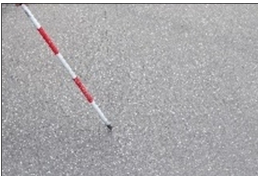
道路標示（白線）が消えている
