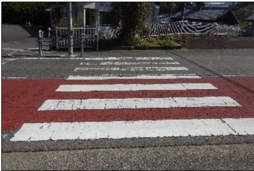
視覚障害者誘導用ブロックがない
