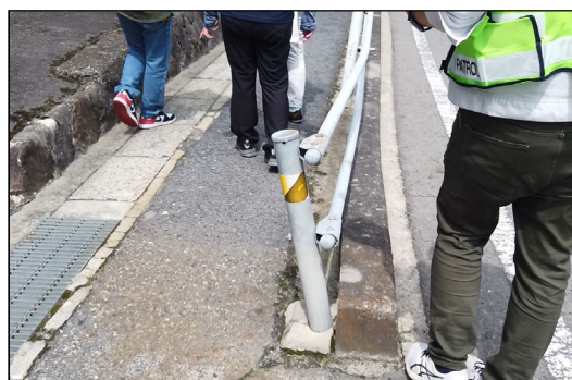
歩道側に変形した横断防止柵
