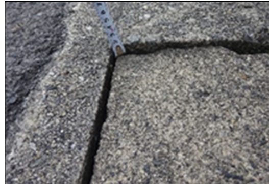
側溝老朽化（両側）、ガタつき、段差
