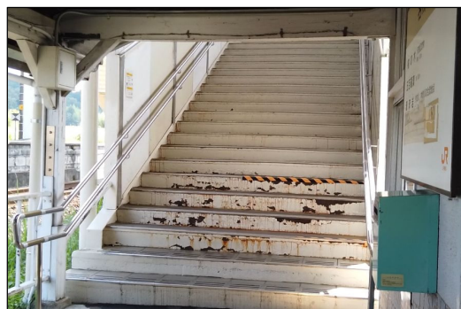
階段の踏面破損
