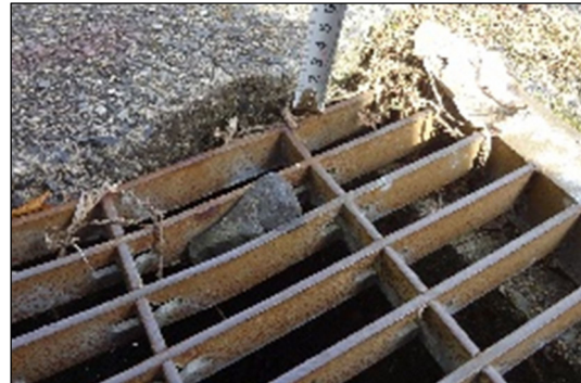
グレーチングの浮き
