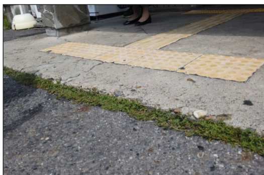
美乃坂本駅舎入口の段差
