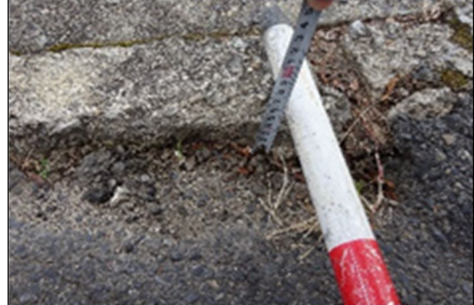
歩道に段差がある
