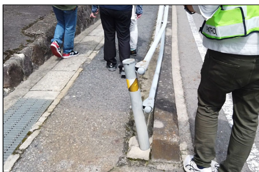
歩道側に変形した横断防止柵
