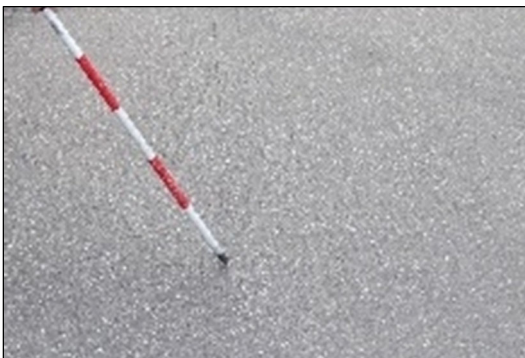
道路標示（白線）が消えている
