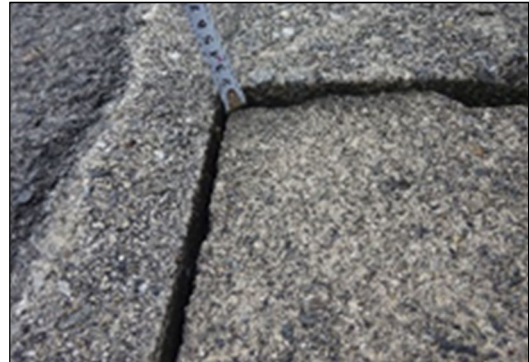
側溝老朽化（両側）、ガタつき、段差
