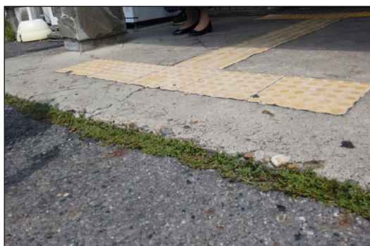
美乃坂本駅舎入口の段差
