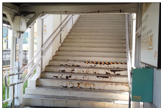
階段の踏面破損
