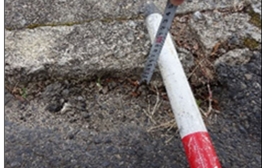
歩道に段差がある
