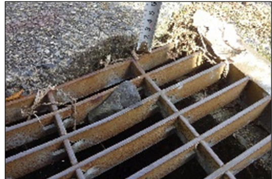
グレーチングの浮き
