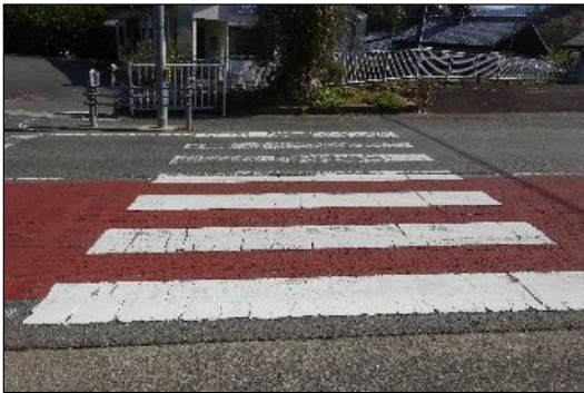
視覚障害者誘導用ブロックがない
