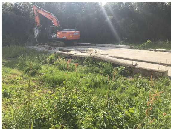
写真 破碎状況
