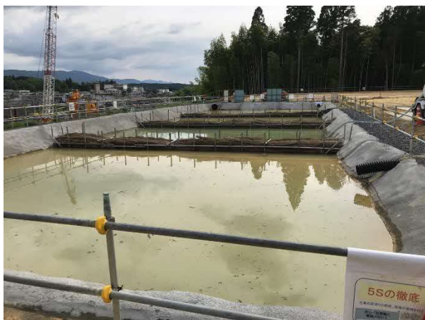
写真 沈砂池の溜水状況
