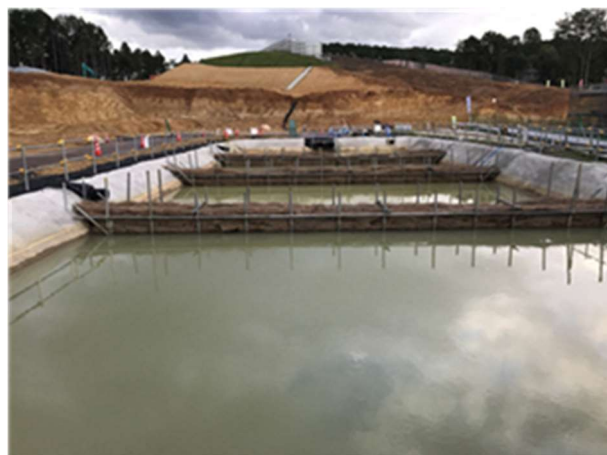
写真 沈砂池の溜水状況
