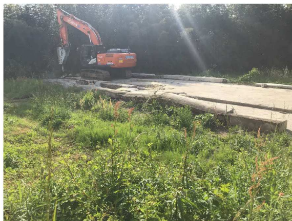
写真 破砕状況
