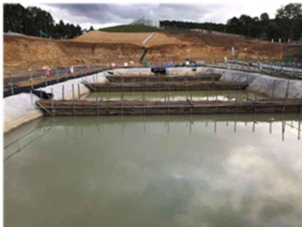
写真 沈砂池の溜水状況
