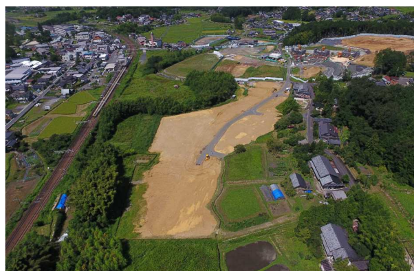
① 【状況写真 R4.8月時点】
