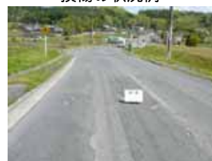
損傷の状況例
