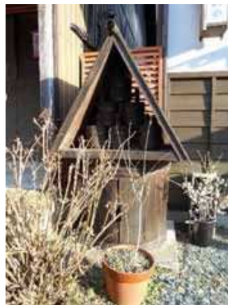
消火器格納箱
