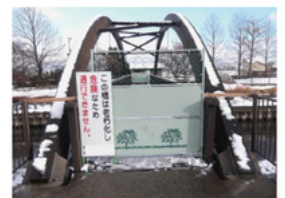
↑ 使用できなくなった 橋梁（他市の事例）
