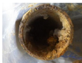
↑ 老朽化した水道管
