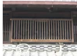
縦線を基調とした和風格子壁面と同色に塗った室外機
