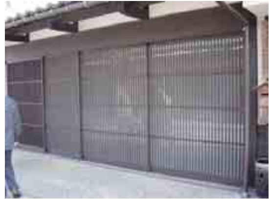
網入りガラス戸の場合は、つや消し黒、目の細かい格子、半透明のガラス戸が望ましい
