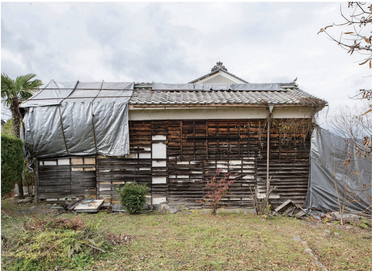
22 土蔵 南面 令和4年現在 雨漏りを防ぐためにシートで応急的に養生している。
