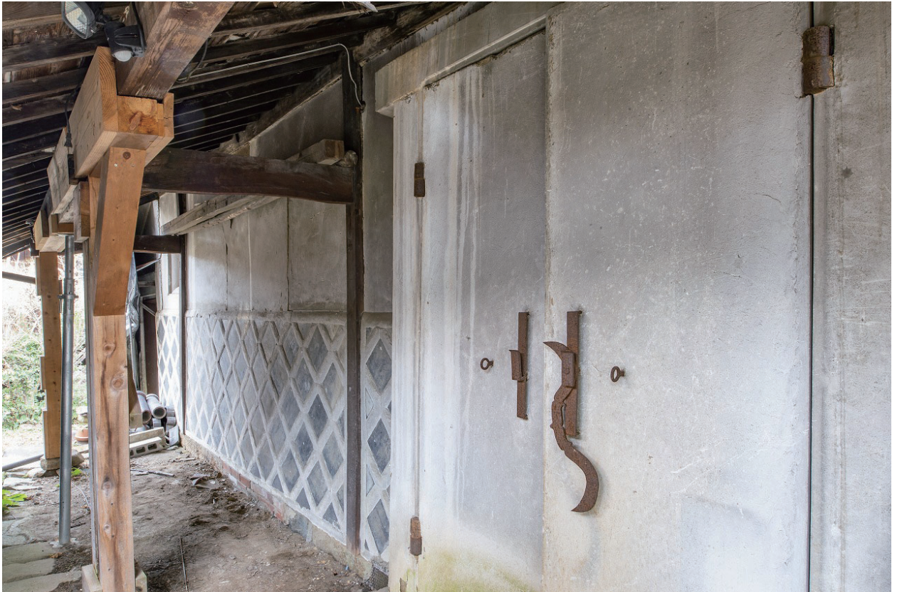
21 土蔵 北面 令和4年現在 庇の軒を支える応急的な補強が行われている。
