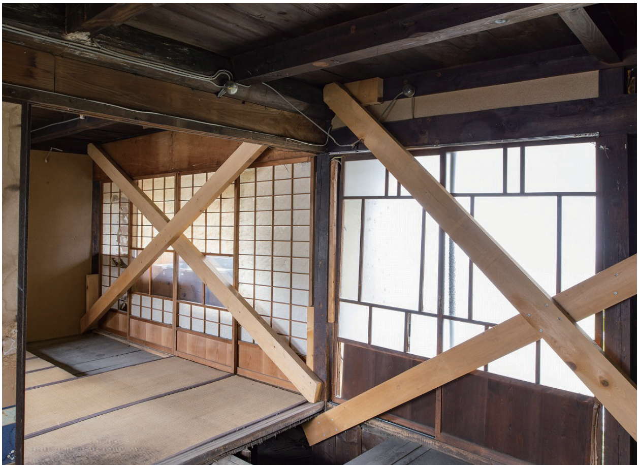
11 離れ 一階 北西隅の六畳間から南側の六畳間にかけて 腰入ガラス障子および腰障子は後補
