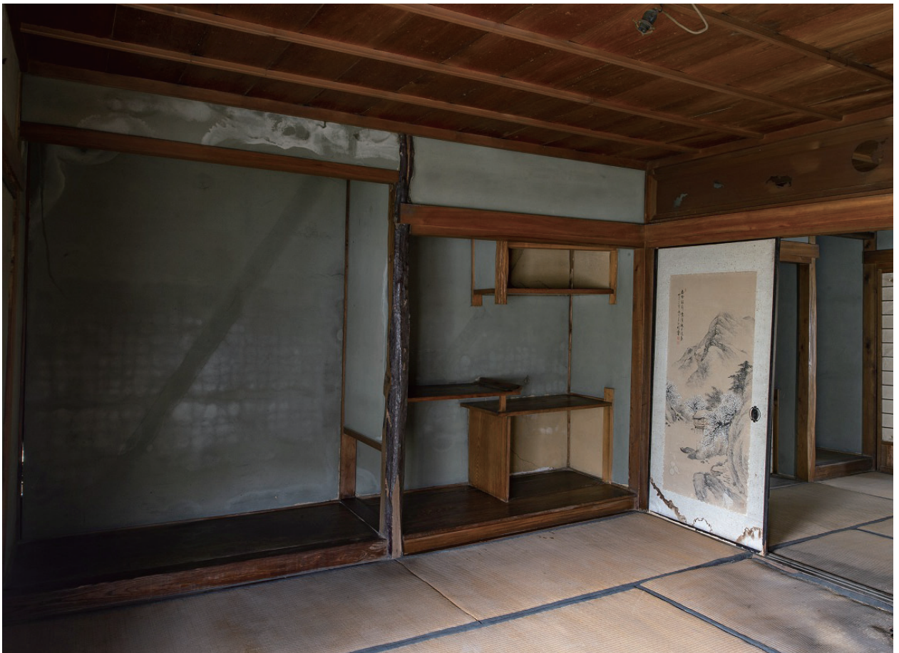
13 離れ 二階 主座敷 座敷飾 西面南半に間口1間の床、北半に間口1間の床脇を備えている。床脇は違棚の下段が間口半間の地袋を兼ね、その上に間口半間の天袋が付く。これも独創的な意匠の床脇である。
