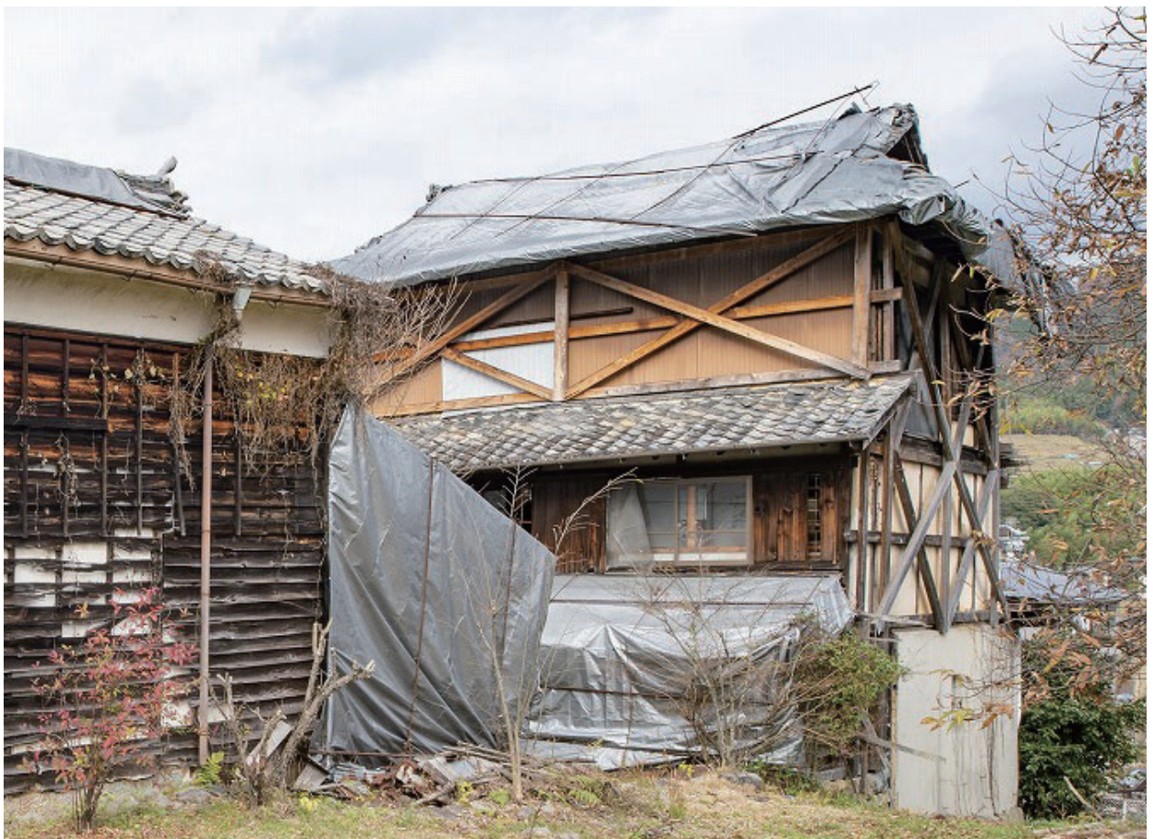
2 離れ 西面南側 令和 4 年現在 倒壊の危険性があるため、応急的な補強と屋根のシート養生を行っている。
