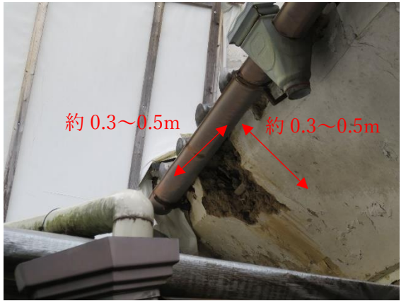
き損箇所②拡大写真
