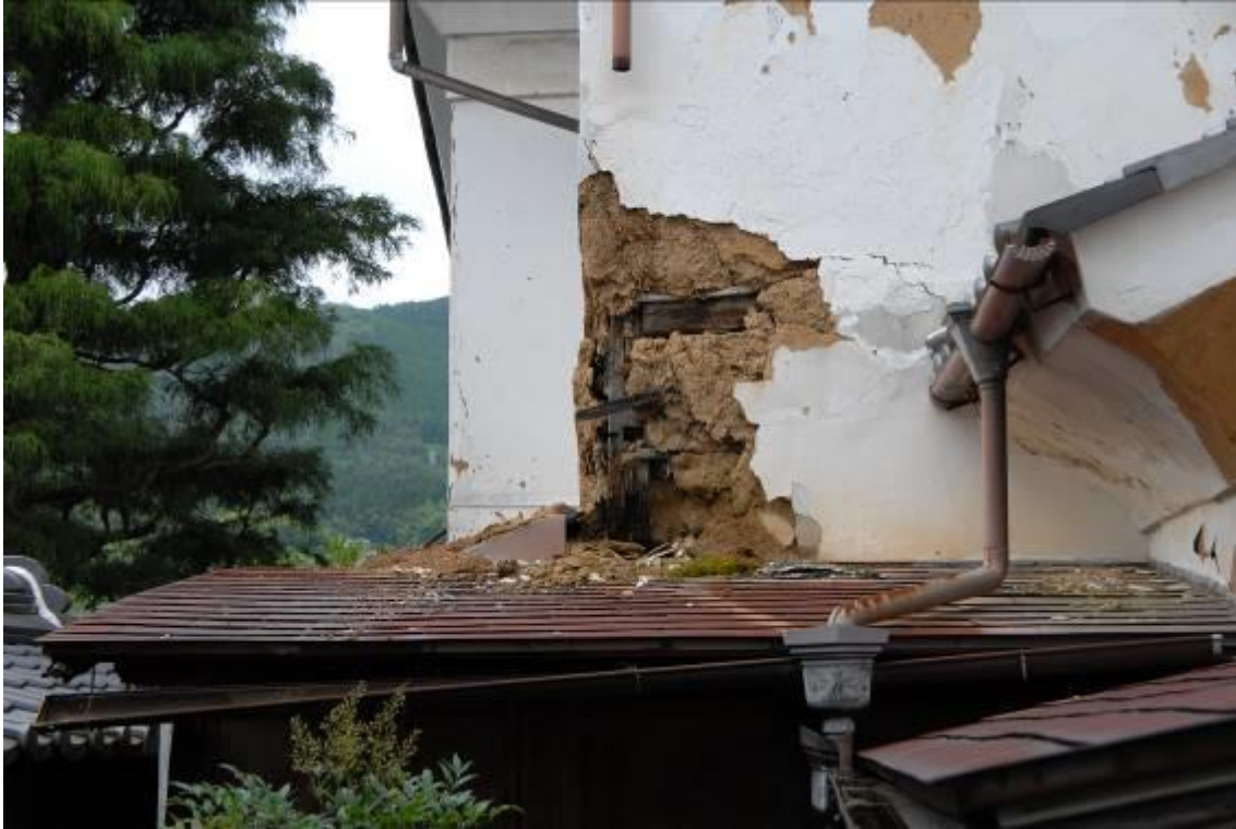
小姓の間外側壁面・下屋屋根破損状況
