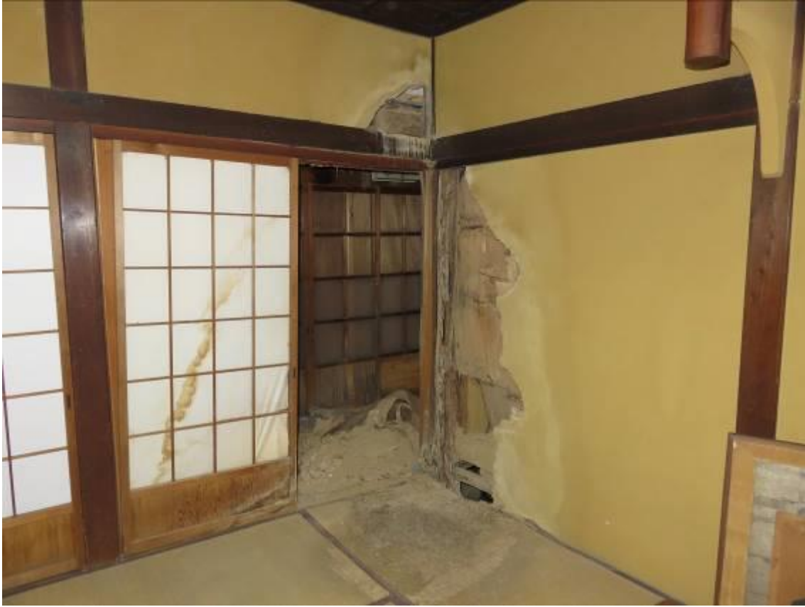
小姓の間破損状況
