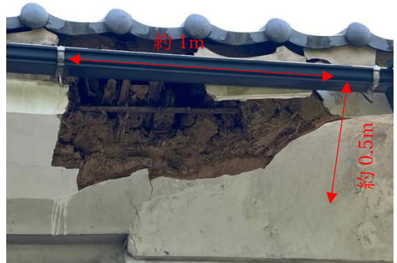
き損箇所①拡大写真
