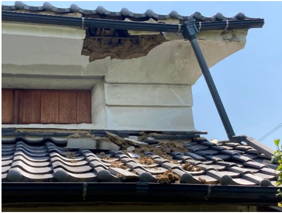
南西から見たき損箇所①
