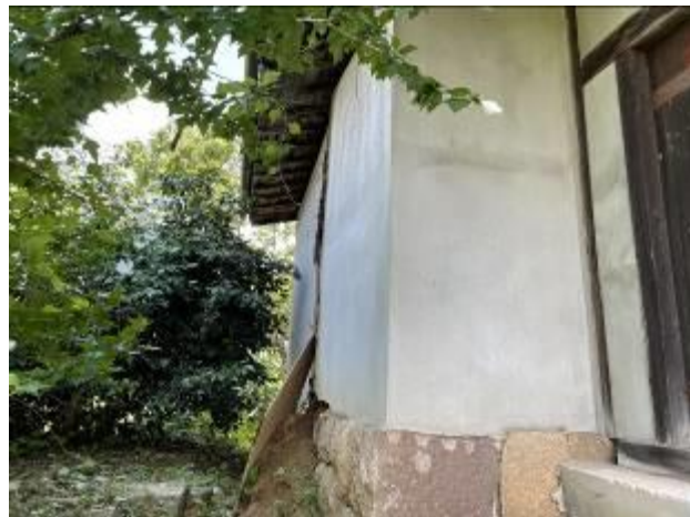
北から見た剥落箇所
