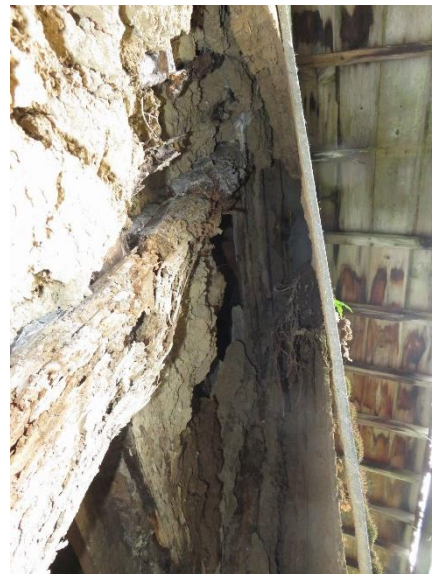
剥落位置裏側状況
