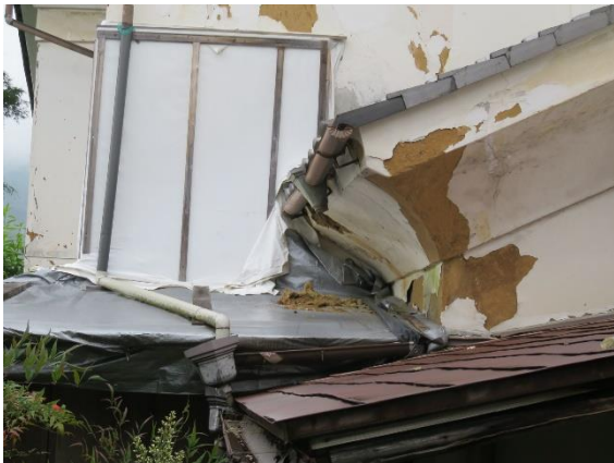
南西から見たき損箇所②
