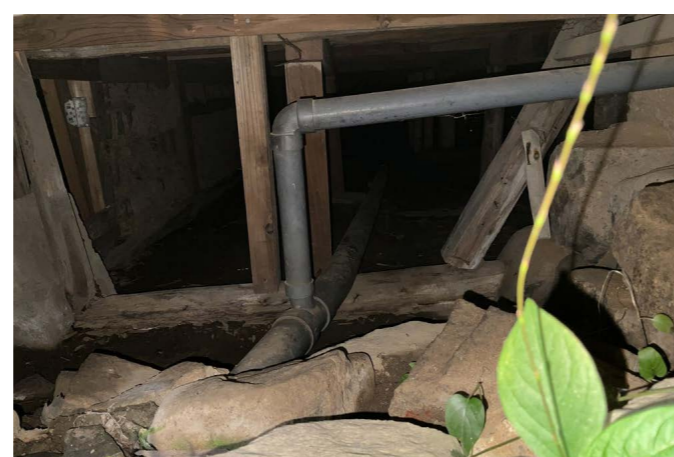
床下配管（小姓の間床下）
