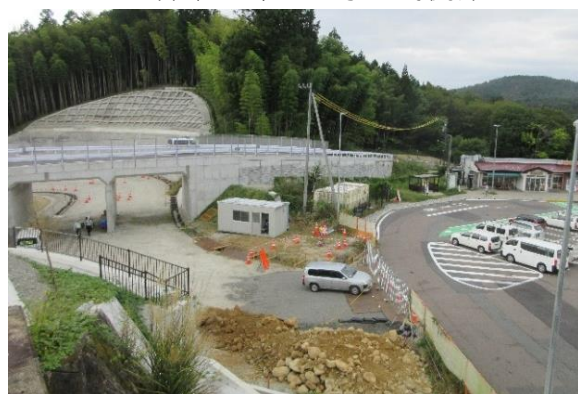
下り線側 PA 付近
