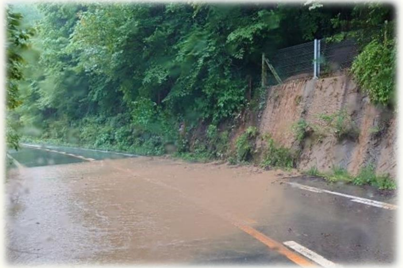
▲県道7号中津川南木曾線は土砂流出で一時通行止めに
