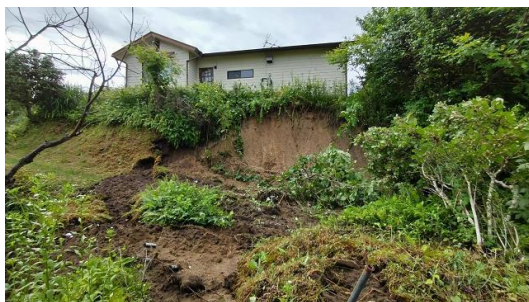
法面崩落(本町)
