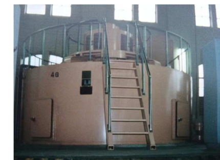
↑増設した縦軸の発電機
