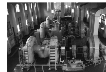
↑改修後の水車と発電機(右端)
