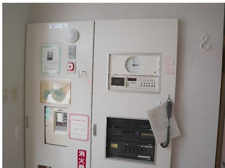
非常用通報装置 複合盤
