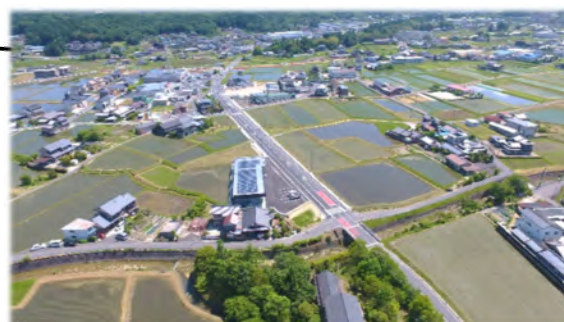
市道坂本264号線 工事の様子 (源長寺様付近) 令和4年度施工延長 L=410m
