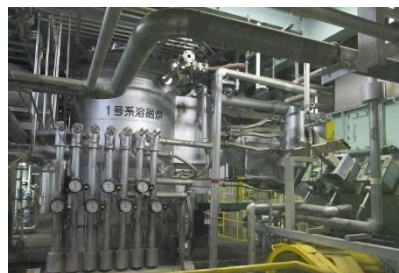
修繕予定である溶融炉
