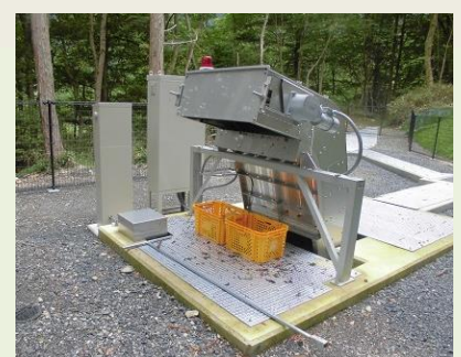
ヘッドタンク・除塵機
