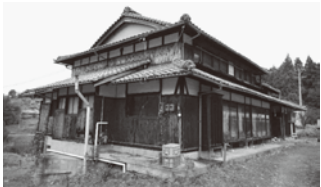
▲築51年、耐震工事未実施、汲み取り式
