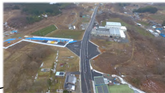
市道坂本58号線他 工事の様子 (袷クマガイ様付近) 令和4年度施工延長 L=240m
